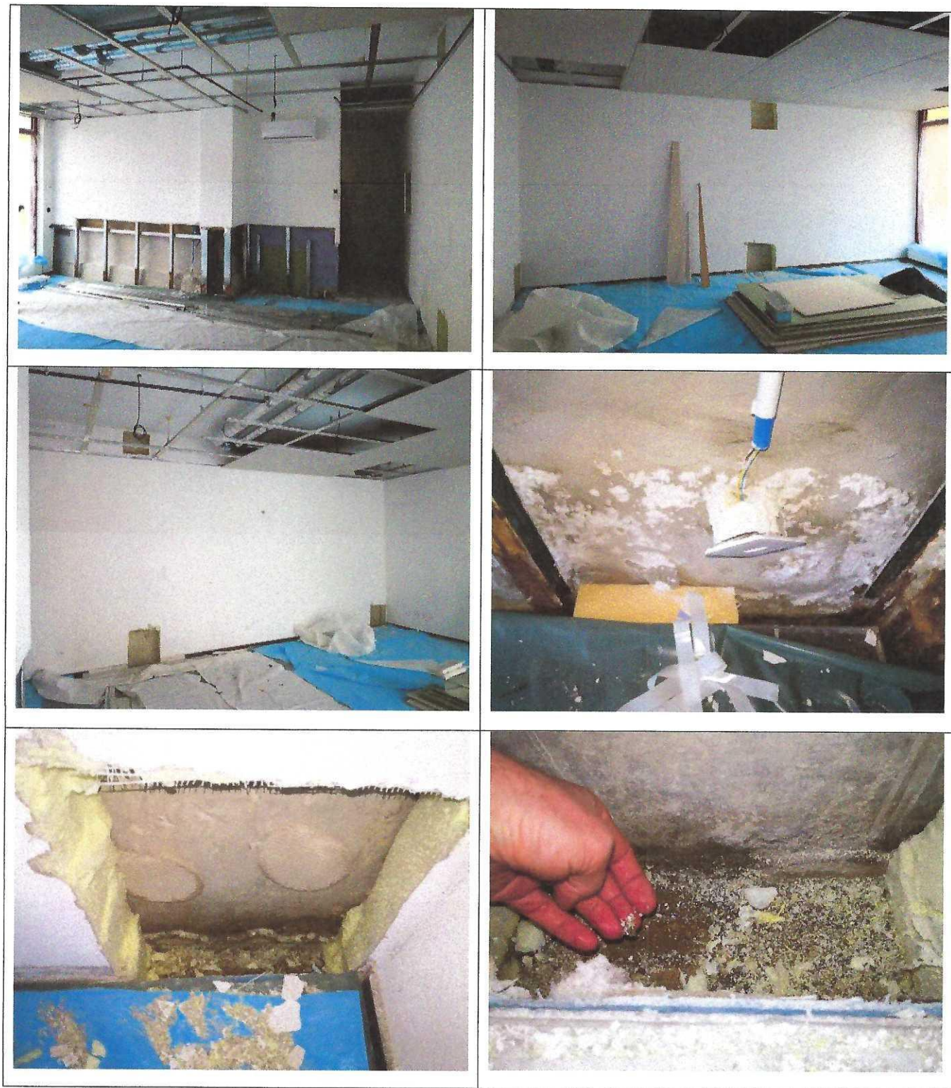
Sondaggi pareti contro terra maggio 2024 – Infiltrazioni dal giunto muro-platea
